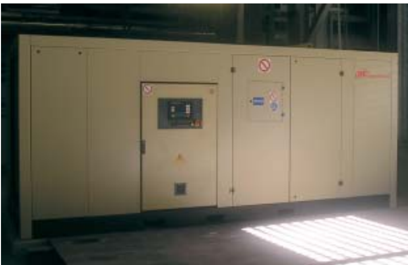
De Centrifugaal compressor met een capaciteit van 3600 m 3 /uur die perslucht levert op de fabriek van Sabic Innovative Plastics.
